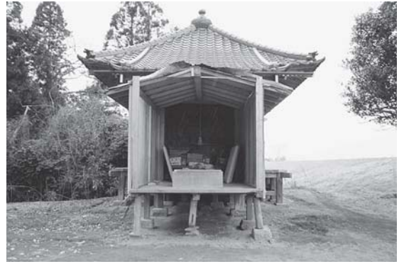
写真 拝殿が倒壊した日月堂
